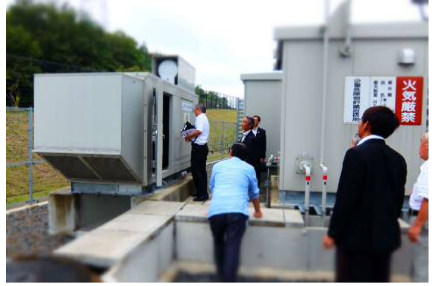
非常用発電機
